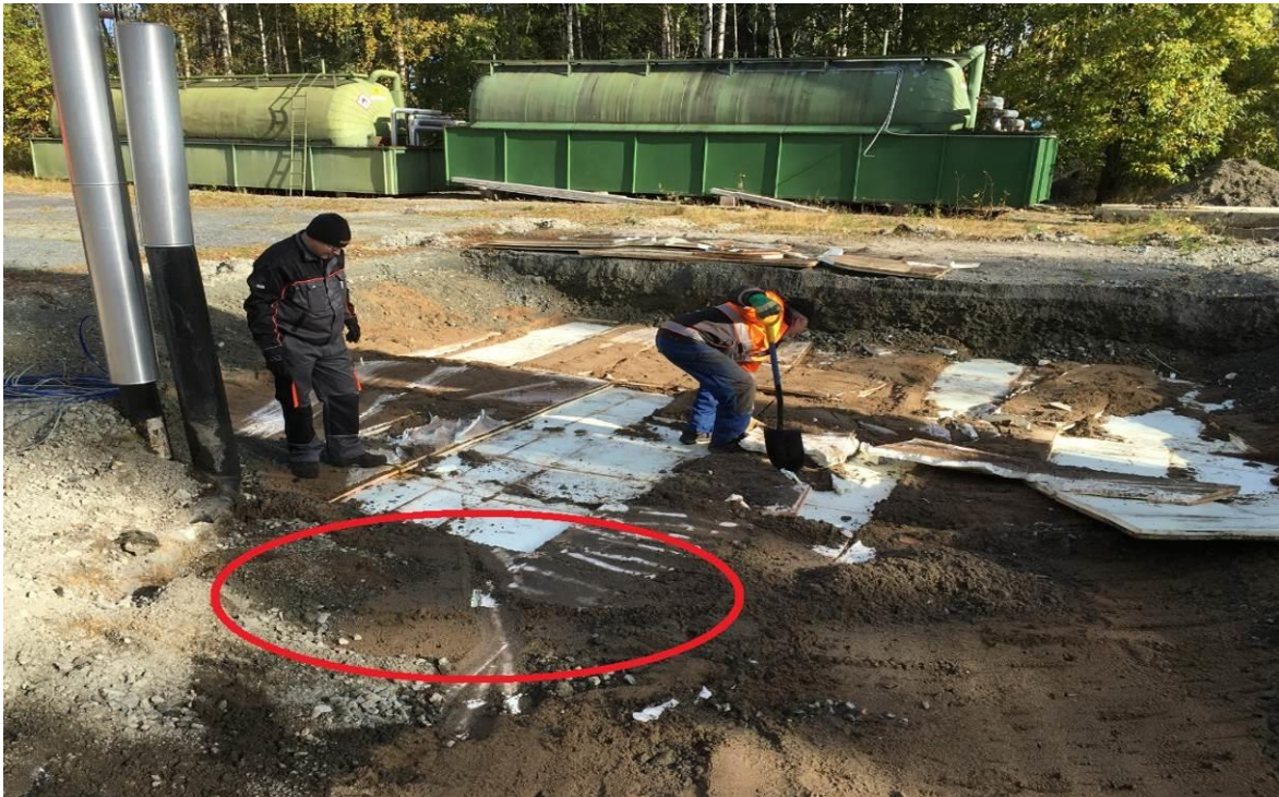
Kuva 1. Vahinkoalue 20.9.16. Öljyvuoalue punaisen ympyrän kohdalla kuvassa. Kuvassa näkyvien eristelevyjen päällä ja väleissä todettiin vapaata öljyä.
