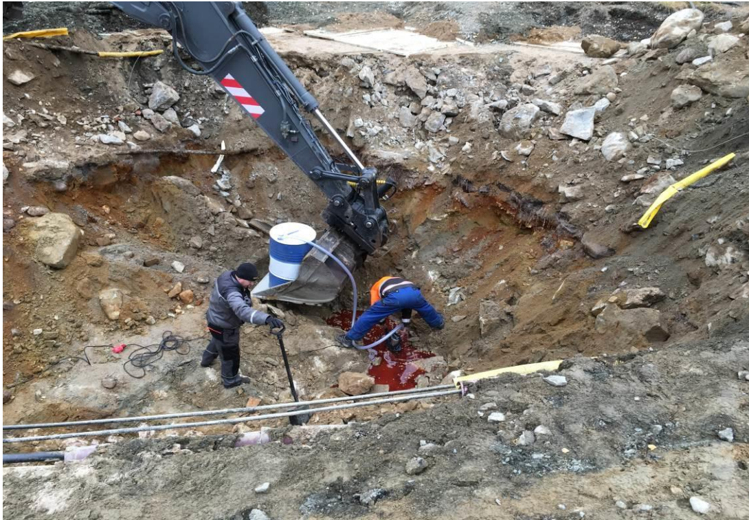
Kuva 5. Kallion pinta kaivettu näkyviin 23.9.2016. Vapaa öljy löytyi koekuoppakaivuna.
