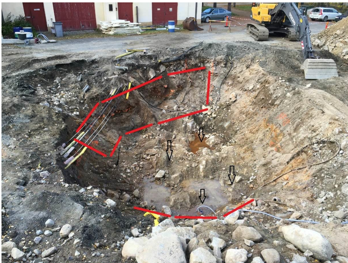
Kuva 3. Punaisella rajattu kuvaan kunnostuksen osalta kesken olevat kaivantoseinämät. Pohjalla on kallio, johon maamassojen kaivu päättyi. Mustien nuolien kohdalla kallionkoloista tihkuu puhtaan näköistä öljyä. Pohjalle kertyy myös vettä.
