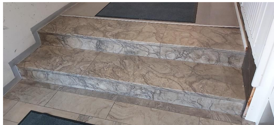
Kauppakadun puoleisen pääsisäänkäynnin yhteydessä on muutama askelma, jonka jälkeen avautuu käytävämainen aula rakennuksen sisätiloihin.
