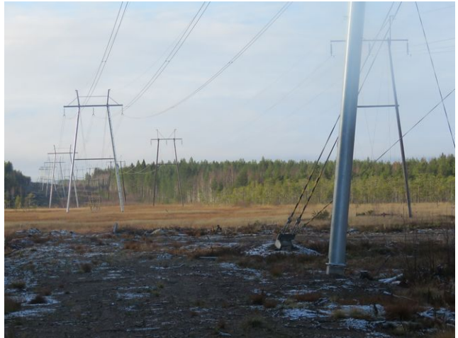
Kuva 10. Pyhäjärvi – Vuolijoki 100 kV linja Korkeamäensuolla, kuvattu lounaaseen.
