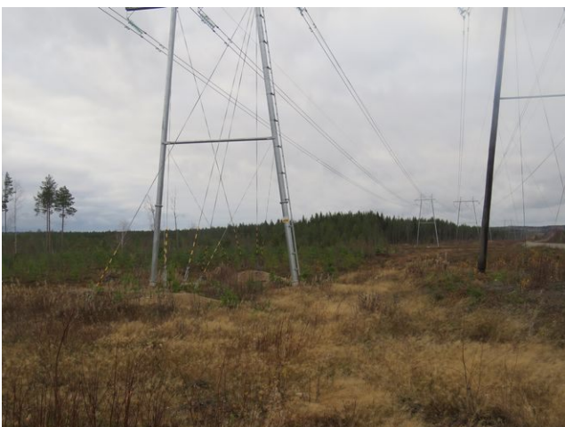
Kuva 25. Linja Humpinmäen kohdalla, länteen.
