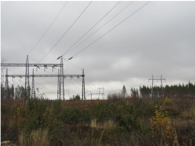
Kuva 23. Pirttikankaan sähköasema, koilliseen.
