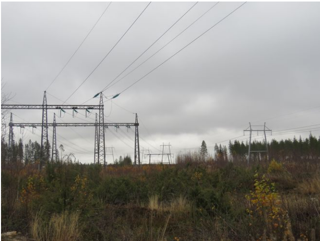
Kuva 23. Pirttikankaan sähköasema, koilliseen.
