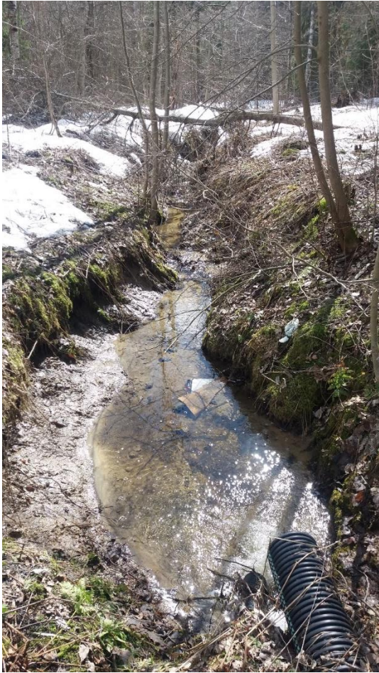
Kuva 9-2. Sadevesiviemärin purkuputki selvitysalueen halki virtaavan ojan yläpäässä.
