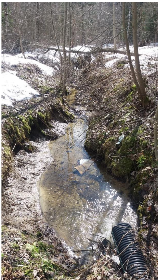
Kuva 9-2. Sadevesiviemärin purkuputki selvitysalueen halki virtaavan ojan yläpäässä.
